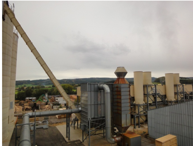
Bild 8: Über ein weitläufiges Fördersystem werden die Sägespäne zu den Spantrocknungsanlagen transportiert.
