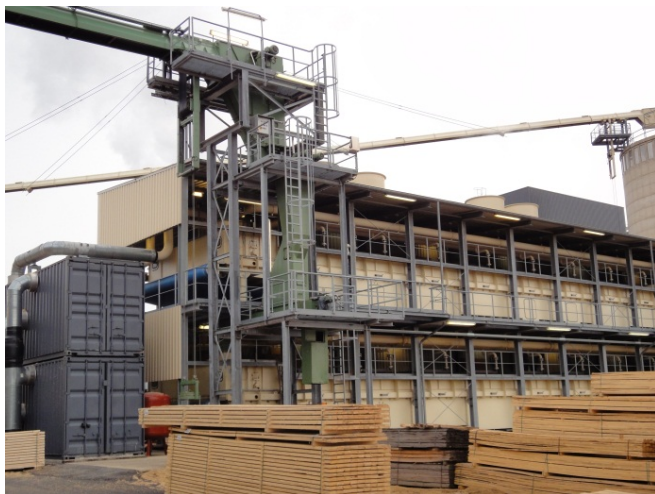
Bild 3: Die übereinander aufgestellten Niedertemperatur-Bandrockner können unabhängig voneinander betrieben werden.
