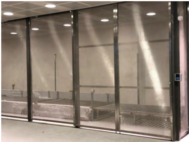
Bild 10: In der Übergepäckausgabe stellt das attraktive Gewebe von GKD als deckenhohe Raumteiler mit integrierter Schiebetür auch seine funktionalen Eigenschaften eindrucksvoll unter Beweis.
